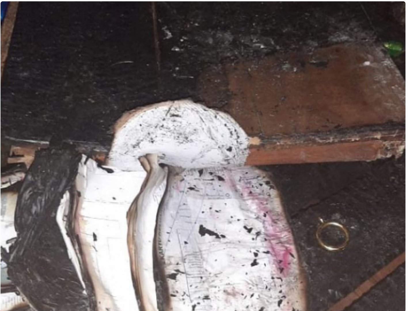
Kondisi terkini Kantor Desa Wolowea pasca kebakaran
